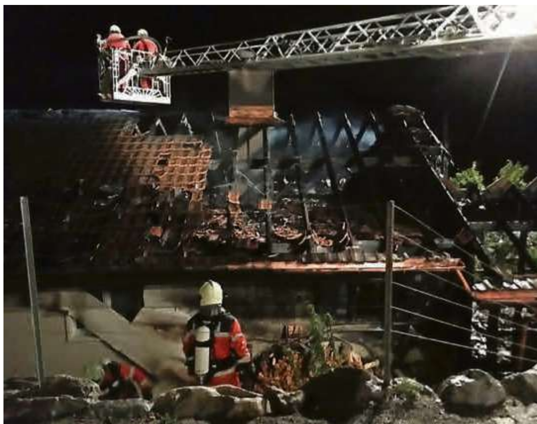
Schlimmeres verhindert: Die Feuerwehr verhinderte, dass die Flammen des brennenden Hauses am Bäretswiler Lettenberg auf die Nachbarhäuser übergriffen – der Dachstock brannte komplett aus.
